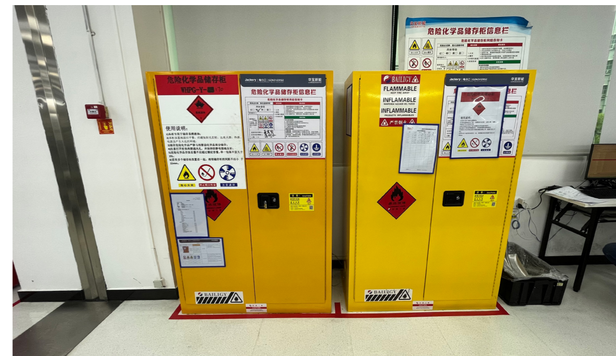
化学品储存柜实景
