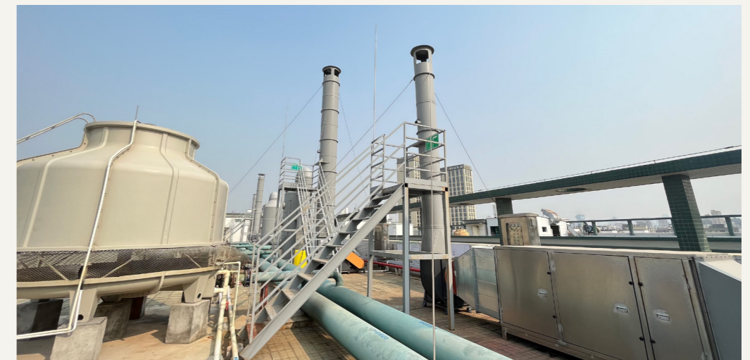
废气处理设施
