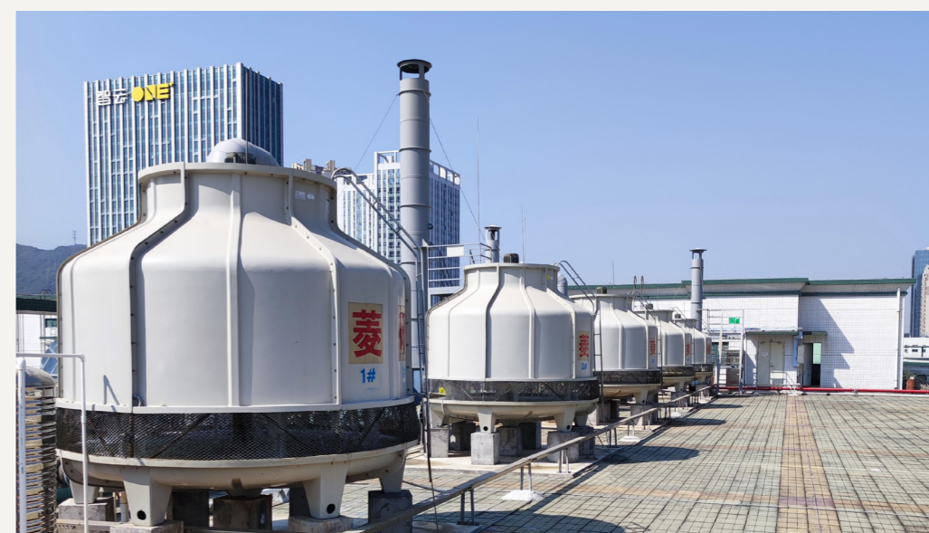
冷却塔平衡管
